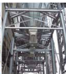
SILOS POUR STRUCTURE UTILISÉS POUR LE DÉCHARGEMENT EN CAMION OU EN TRAIN
