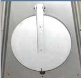
PUERTA DE INSPECCIÓN
