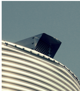
AÉRATION DANS LE TOIT
